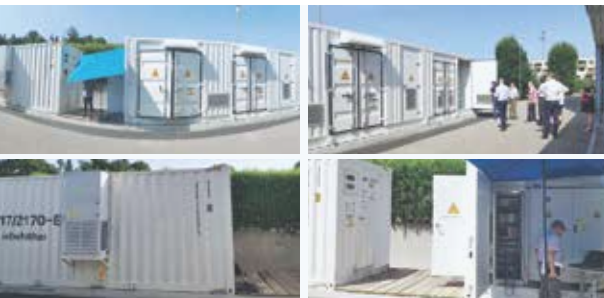
2MW/2.17MWh 瑞士调频储能项目
