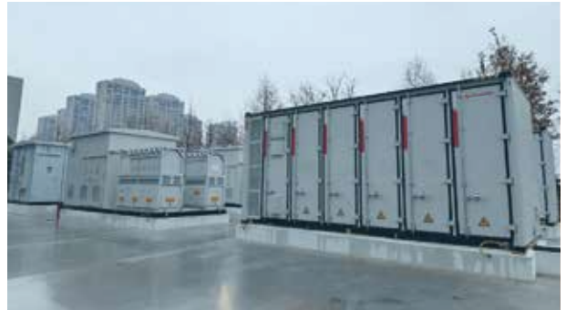
7.5MW/15MWh 浙江宁波工业园储能项目
