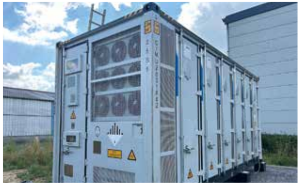
25MW/55MWh 比利时储能项目
