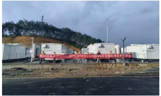
200MW/400MWh 云南景洪共享储能电站项目
