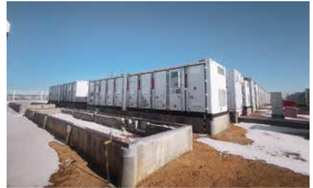
14MW/56MWh 甘肃酒泉中能布隆吉储能电站改造项目
