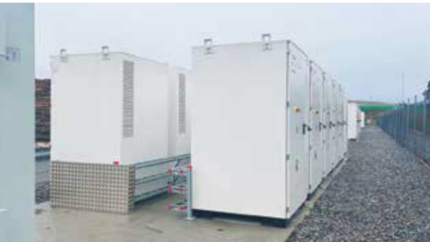
21MW/42MWh 瑞典克里斯蒂安斯塔德储能项目
