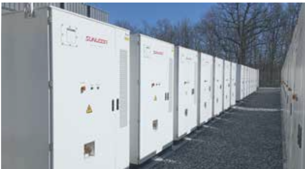
70MW/70MWh 瑞典斯德哥尔摩储能调频项目
