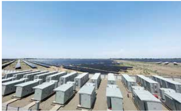
60MW/120MWh 甘肃金塔光伏储能系统项目
