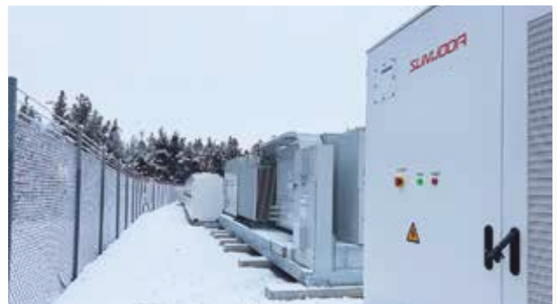
45MW/45MWh 瑞典斯塔沃储能项目
