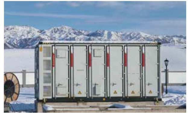
50MW/100MWh 中国西北风电配储能电站项目
