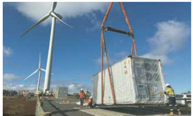
2.5MW/5MWh 澳大利亚风电场直流耦合项目
