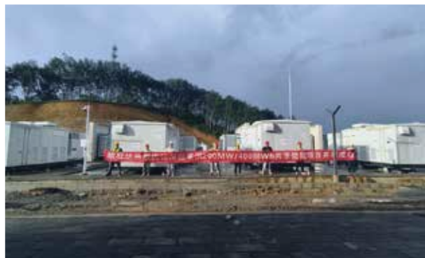
200MW/400MWh 云南景洪共享储能电站项目
