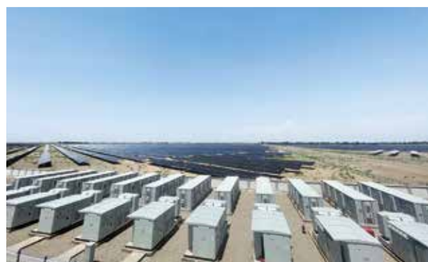
60MW/120MWh 甘肃金塔光伏储能系统项目
