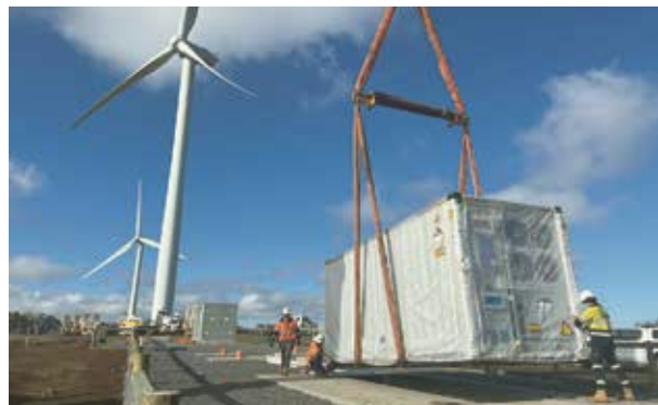
2.5MW/5MWh 澳大利亚风电场直流耦合项目
