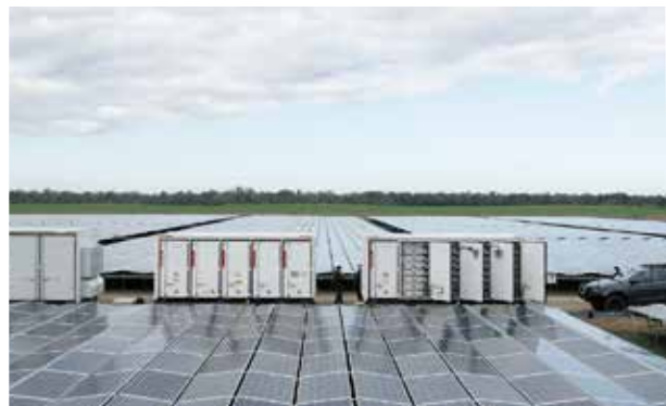
5MW/11MWh 澳大利亚配电网侧光储直流耦合项目
