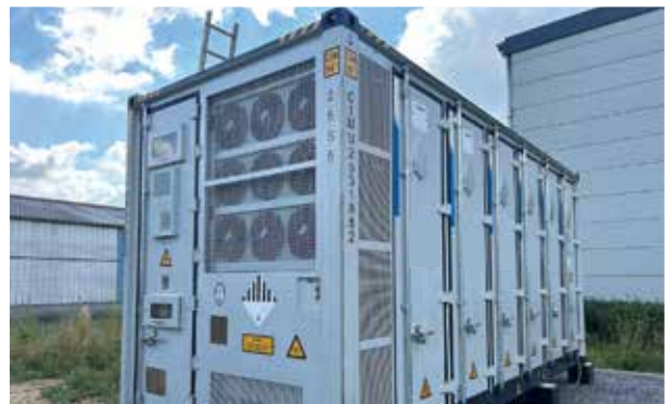
25MW/55MWh 比利时储能项目
