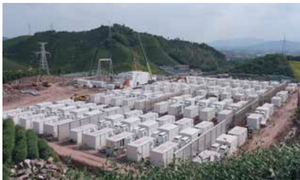
200MW/400MWh 浙江武义电网侧储能项目 纳入浙江省新能源十四五发展计划，被列入2024年浙江“千项万亿”工程
