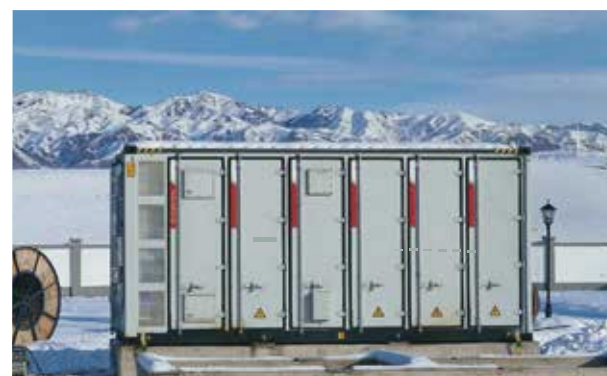
50MW/100MWh 中国西北风电配储能电站项目
